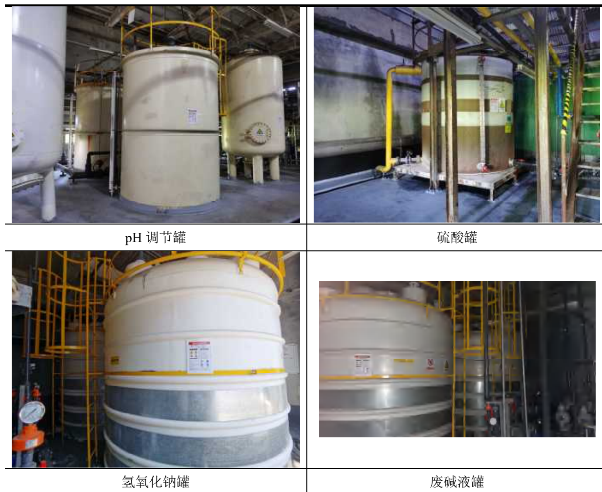
图 3-1 污水处理站现场照片
