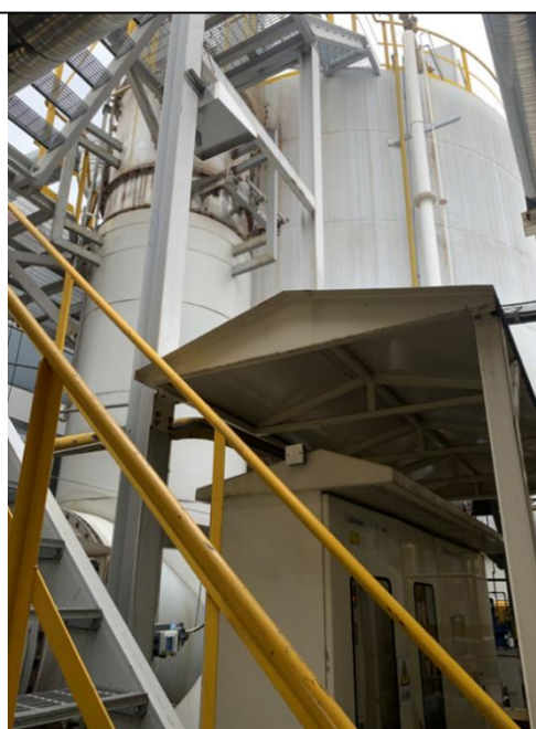
RTO燃烧装置
