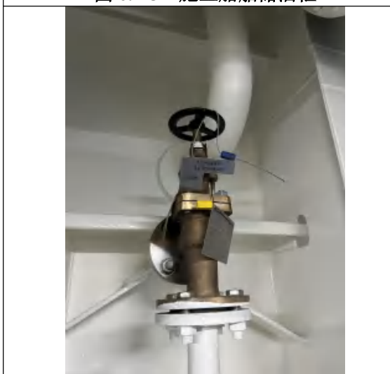
图 6.1-7 施工船舶油水分离器铅封
