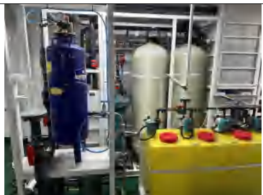
图 6.1-6 施工船舶油水分离器
