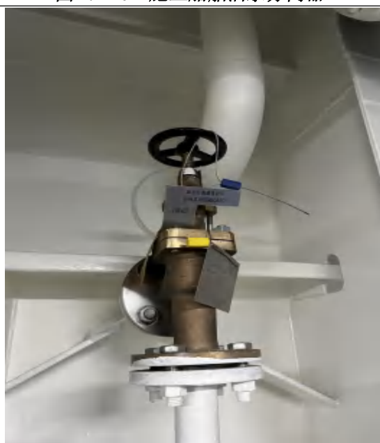
图 4.1-12 施工船舶油水分离器铅封
