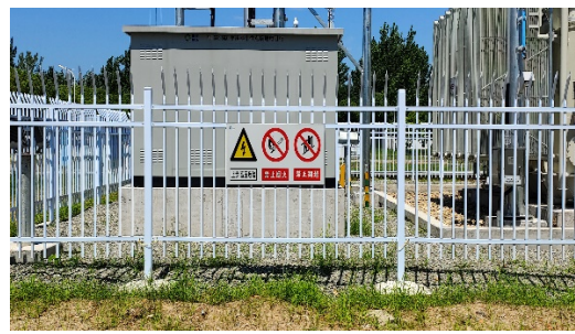
升压站安全警示标志
