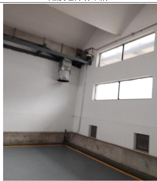
危废仓库内监控设备
