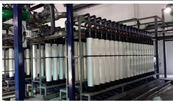
污水深度处理回用装置
