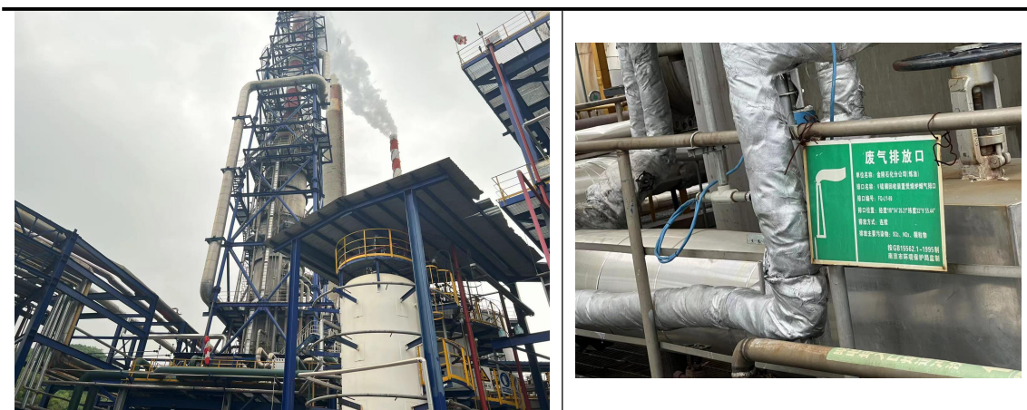
V 硫磺回收装置焚烧炉 DA045 排气筒及标识牌
