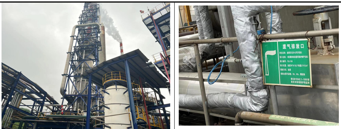
V 硫磺装置焚烧炉+低氮燃烧器+氨法脱硫塔+DA045 排气筒及标识牌
