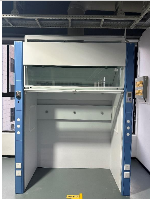
产品调试废气收集措施
