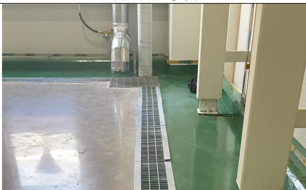
危废库防渗及收集槽
