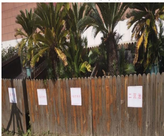
图 6-5 集控中心地埋式一体化污水处理设
