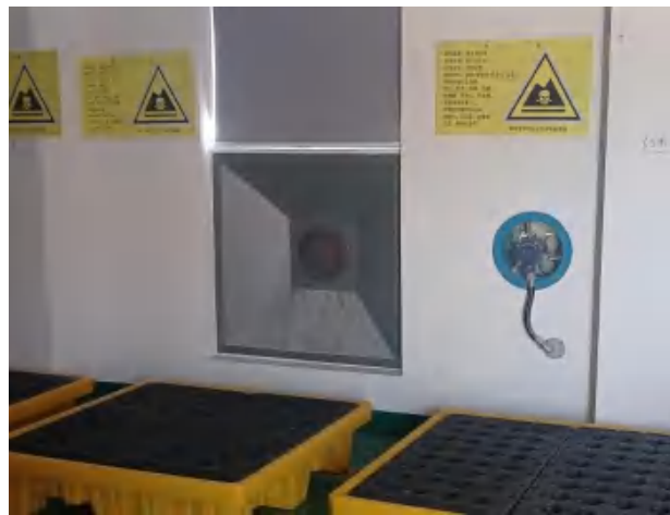
危废库中集气管道
