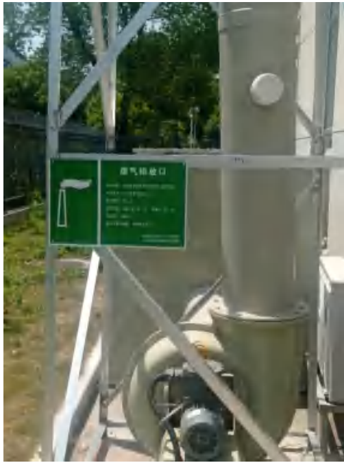
危废库活性炭吸附装置、标识牌及采样口
