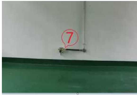
危废库内有机气体报警装置
