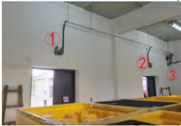
1、防爆应急照明灯；2、防爆应急照明灯； 3、防爆监控摄像机。
