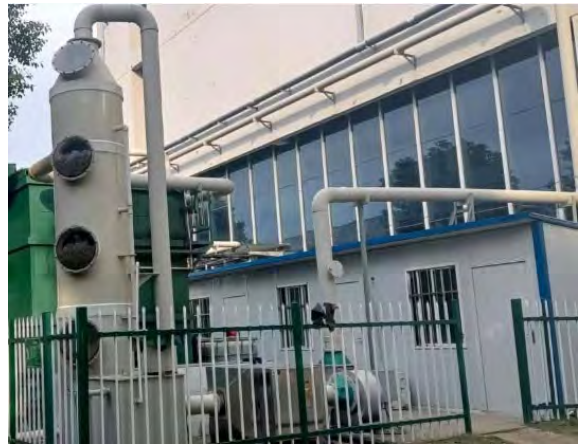
污水处理站废气处理设施
