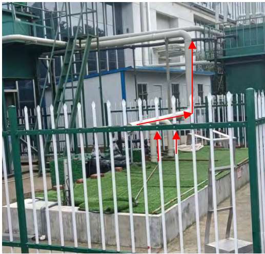
污水处理站废气收集
