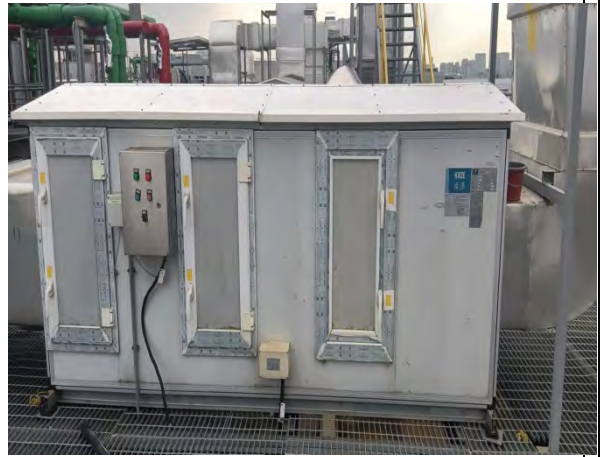
研发废气和危废库废气处理设施
