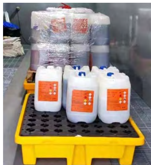
集装箱危废暂存间防滲托盘
